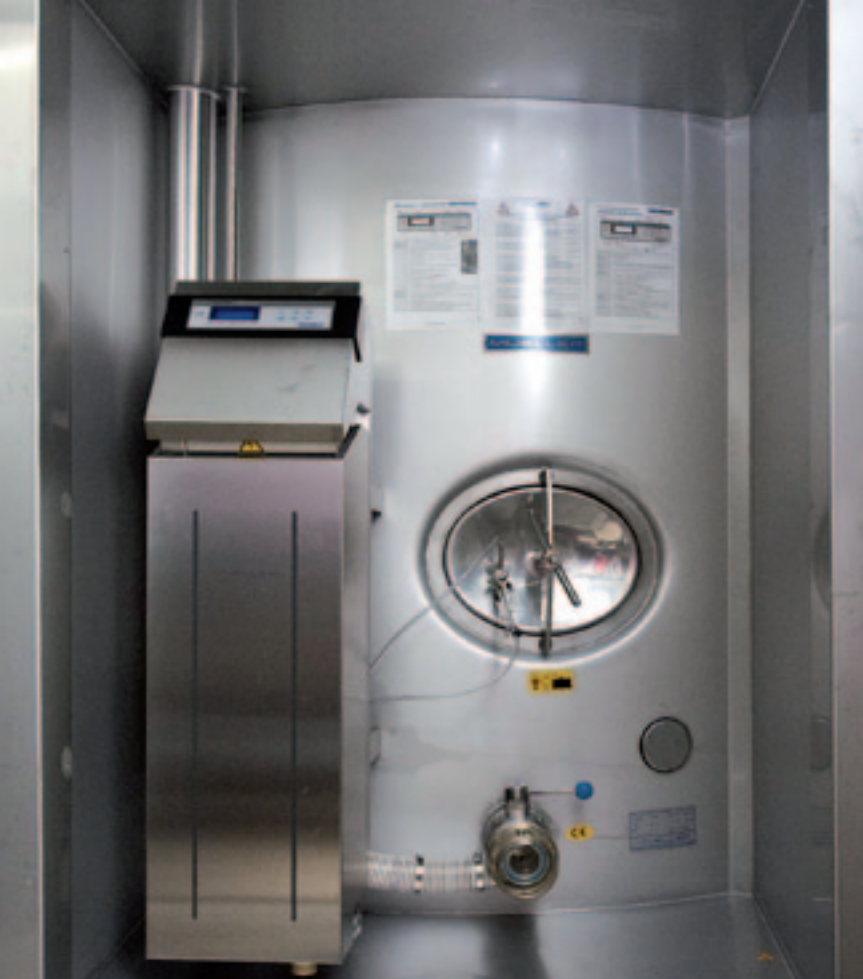
De alkoof is de verbinding tussen de silotank en het tanklokaal. Via de alkoof moeten mangat, monsternamekraantje, uitloop en inlaat bereikbaar zijn.
